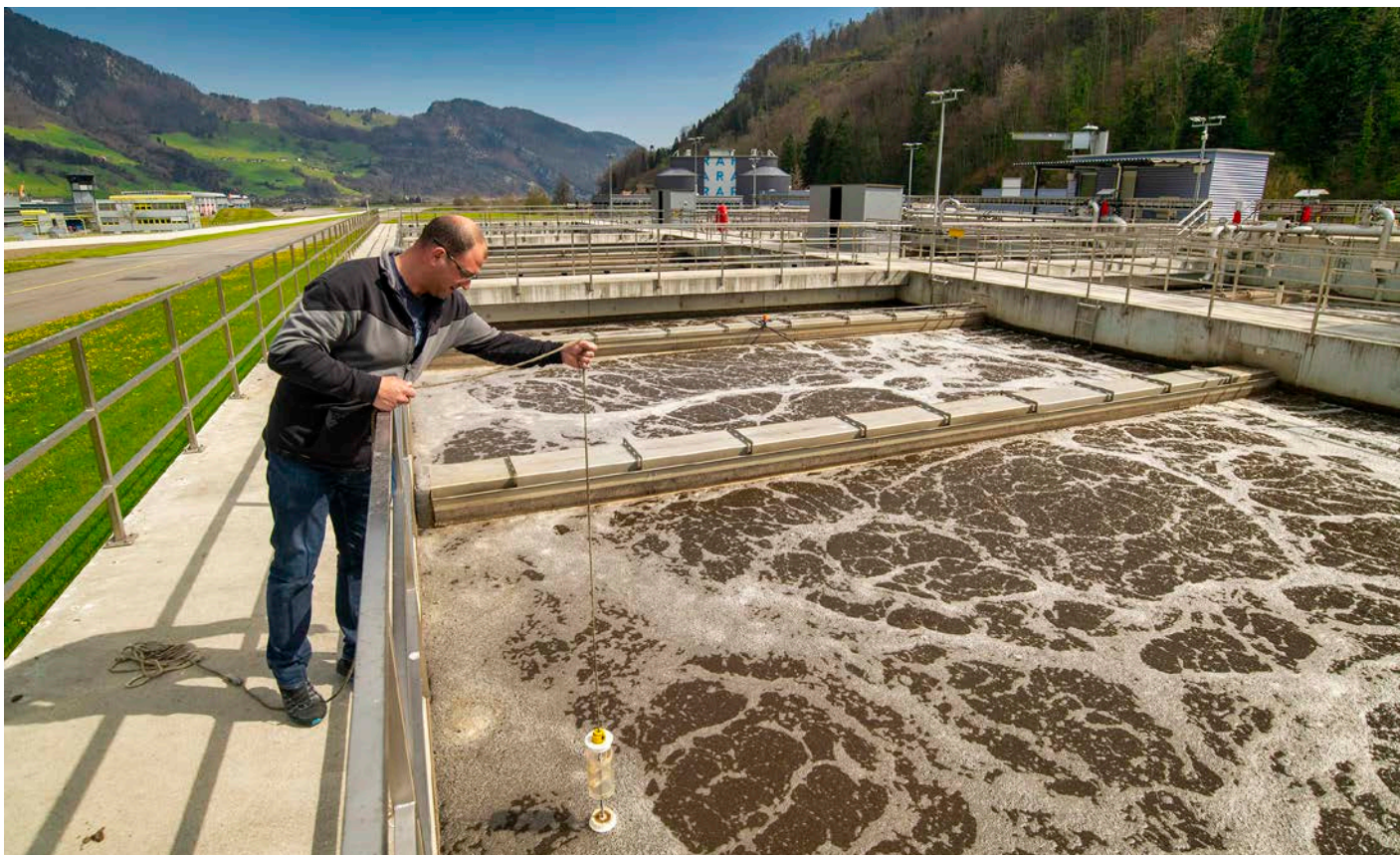
Die ARA Sarneraatal ist eine der modernsten der Schweiz: Betriebsleiter Stefan Kälin entnimmt eine Probe – so wird die hohe Qualität gesichert, bevor das Wasser wieder in den natürlichen Kreislauf fliesst.
